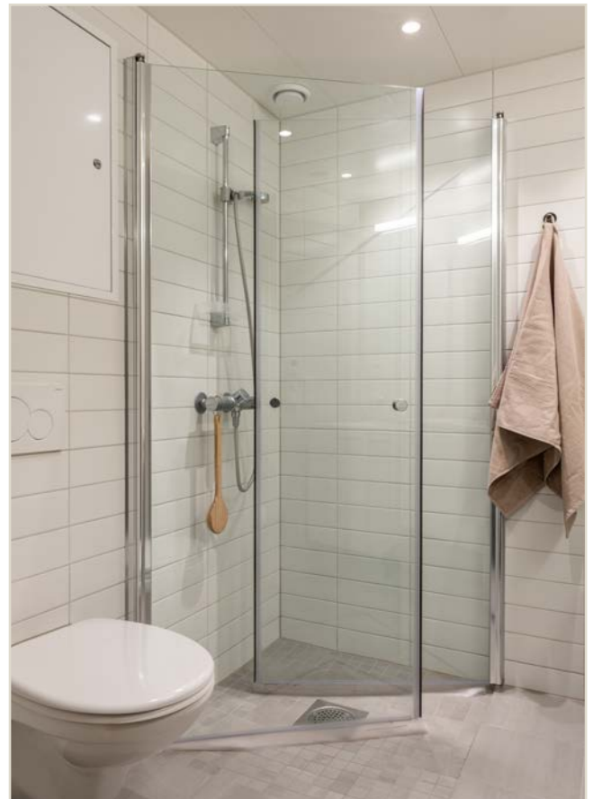
Veggmontert toalett. Dusjhjørne med glassdører, sluk i sone og dusjstyr. Opplegg for vaskemaskin.
