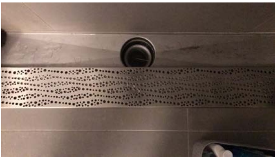
Stålsluk med klemring og vannlås, plassert i nedsenket dusjsone.
