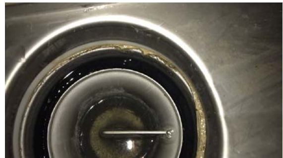
Gulvmembran påvist/innfestet i sluk.
